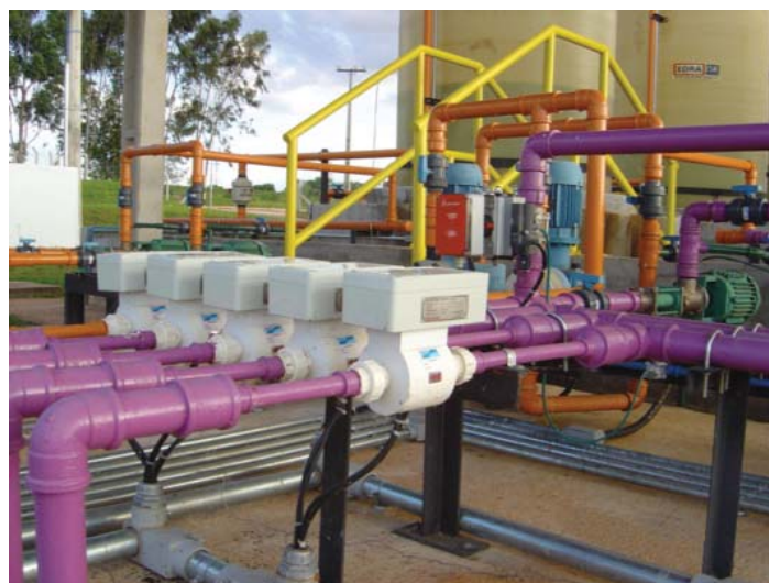
Aplicação do VMS® em linha de dosagem de produtos químicos em ETE da Caesb
