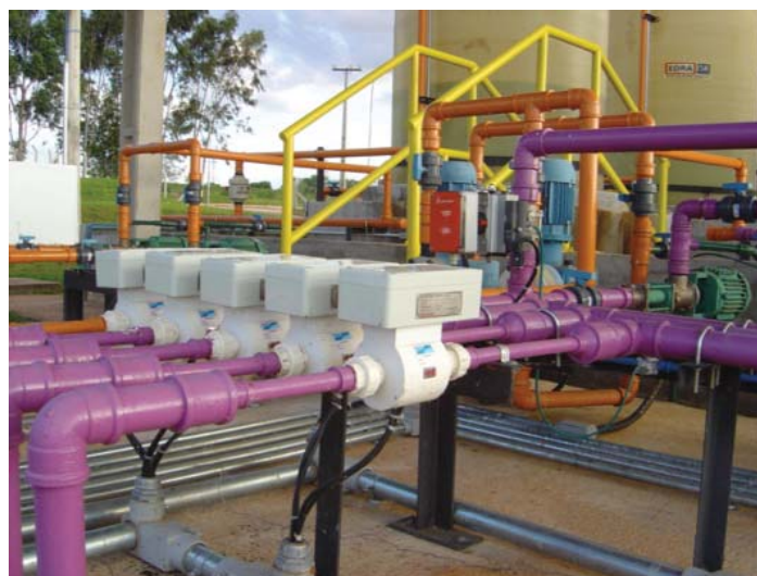
Aplicação do VMS® em linha de dosagem de produtos químicos em ETE da Caesb
